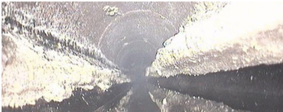
Fett som samlats på insidan av spillvattenledningar.
